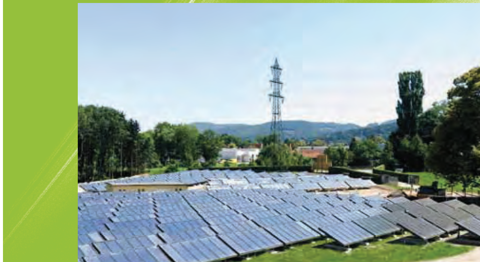
Kollektorfeld am Gelände des Wasserwerks Andritz
